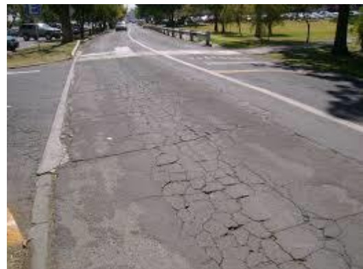
Fig. 2.3 Pavimento piel de cocodrilo
